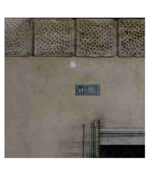
Degrado ed erosione differenziale con distacco di muratura. Zoccoli in trachea con depositi superficiali. Muratura adorno deteriorata.
