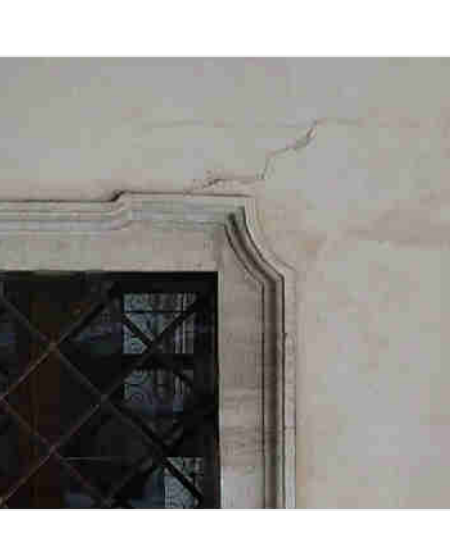
Infissi adibbruciati e deteriorati, con compatte dissono di muratura.
